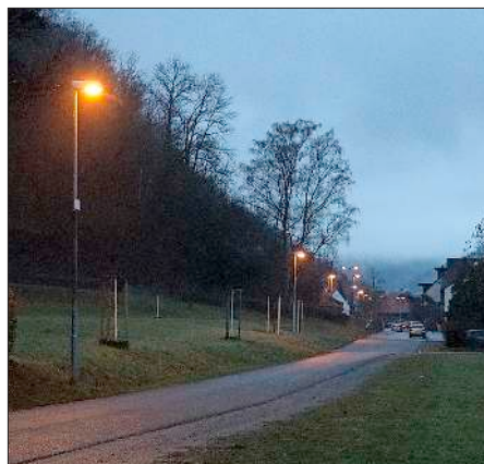
Die Umrüstung der Straßenbeleuchtung auf LEDs wird forciert
